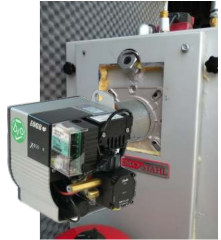
Λέβητας με υπερπριεστικό καυστήρα νέας τεχνολογίας EOGB
