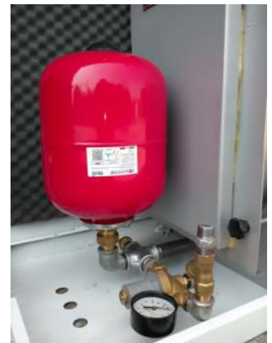
Δοχείο διαστολής - Αυτόματος πλήρωσης με μανόμετρο - Κρουνοί εκκένωσης - Φίλτρο άμμου στο εμπρόσθιο τμήμα, κάτω από το λέβητα
