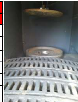
Εσωτερικό θαλάμου καύσης με την εστία καύσης, τις σχάρες για τα ξύλα και το μαντεμνίο καταλύτη
