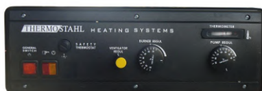
Αναλογικός πίνακας με ροοστάτη για τη ρύθμιση του φυσητήρα
