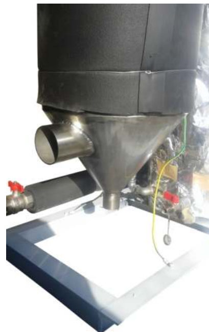
Έξοδος καυσαερίων και απόληξη συγκέντρωση συμπυκνωμάτων
