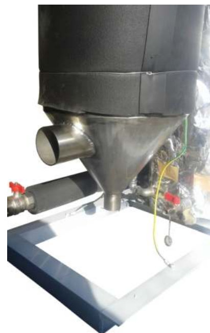
Έξοδος καυσαερίων και απόληξη συγκέντρωση συμπυκνωμάτων
