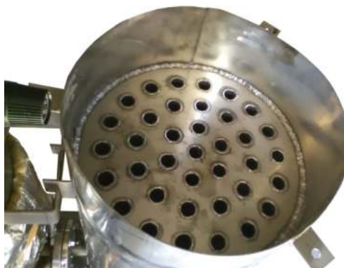
Σωλήνες καυσαερίων στο εσωτερικό του εναλλάκτη συμπύκνωσης
