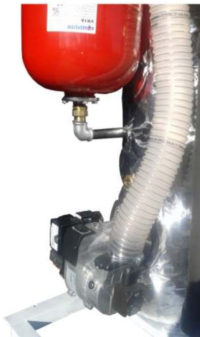
Καυστήρας Bentone με αγωγό προσαγωγής προθερμασμένου αέρα καύσης
