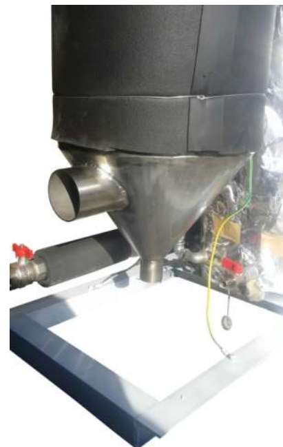
Έξοδος καυσαερίων και απόληξη συγκέντρωση συμπυκνωμάτων
